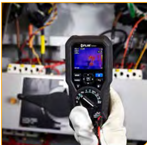
Balayage thermique d'un tableau électrique
