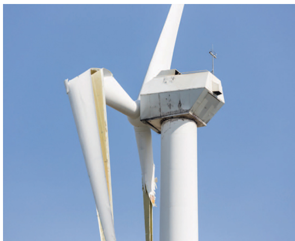
Figures 2a and 2b: Dommages causés par les foudres sur les éoliennes
